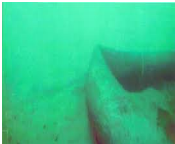
写真1 錨に引きずられて変形した取水管
