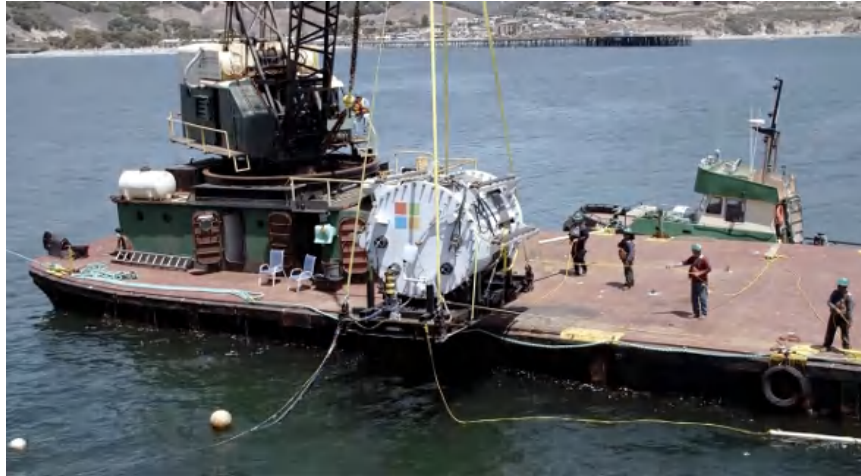
「Project Natick」で海中に設置されるデータセンター 出典：Project Natick
